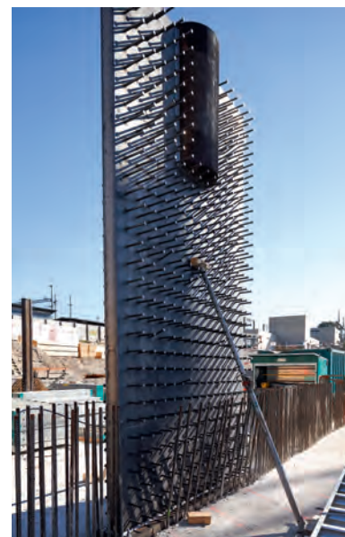
Fig. 5 Krafteinleitungsdetail im 2. Untergeschoss der Hauptstützen. Force introduction detail in the 2nd basement floor of the main columns. (© Martin Stollenwerk)
