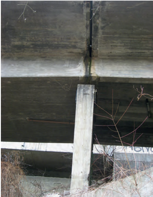
Fig. 4 Undichte Dilatationsfuge bei Stütze C. Leaking dilatation joint at support C.
