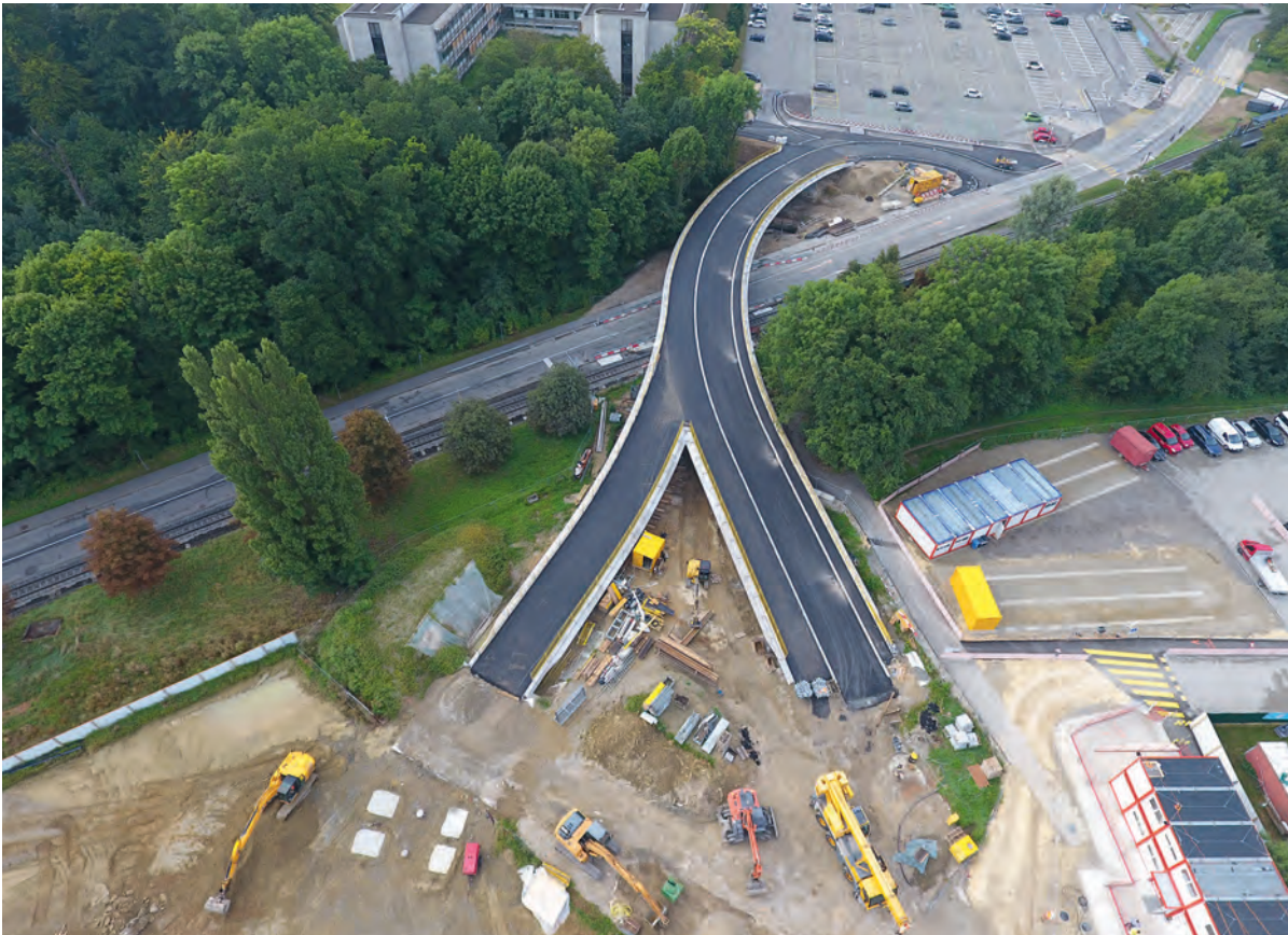
Fig. 1 Vue aérienne du nouveau pont de la Sorge. Aerial view of the new bridge over the Sorge.
