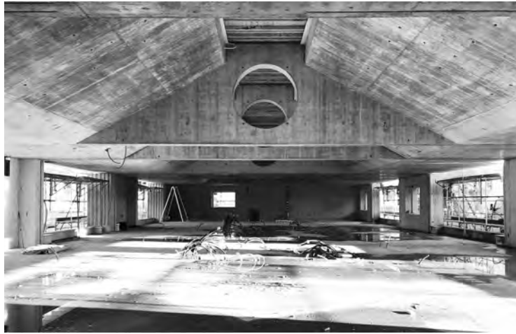
Fig. 2 Innenraum im Rohbau mit reiner Tragstruktur. Interior in shell construction with load-bearing structure.
