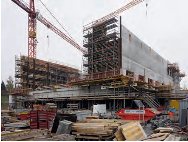
Fig. 5 Bau der Seitenwände Trainingshalle. Constructing the side walls of the training hall. (Foto: Dominique Uldry)
