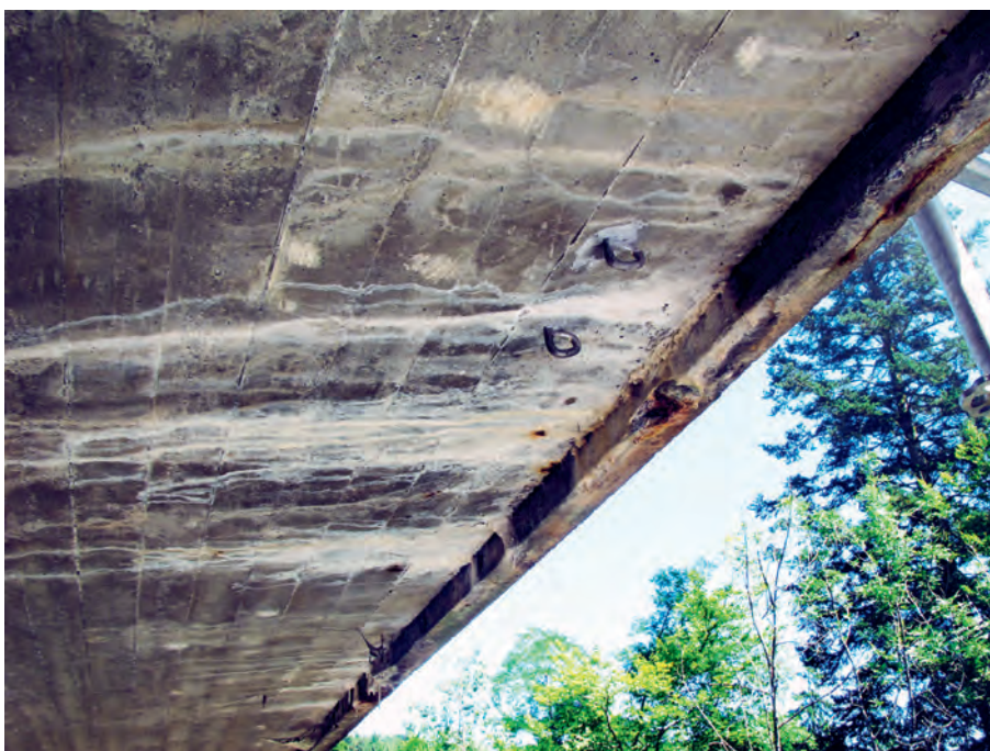
Fig. 3 Dégradations avant travaux sous les porte-à-faux. Deterioration before work, under the cantilevers.
