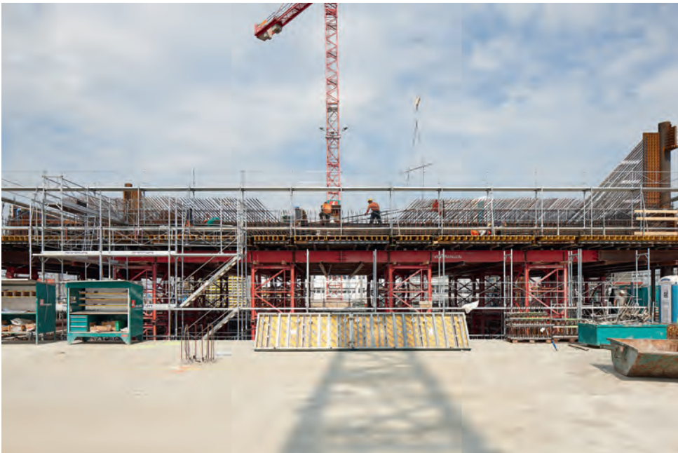
Fig. 4 Ansicht des Lehrgerüsts des Mitteltrakts und der um 45° geneigten Anschlussbewehrung. View of the falsework for the central wing and the 45° inclined connecting reinforcement. (© Martin Stollenwerk)
