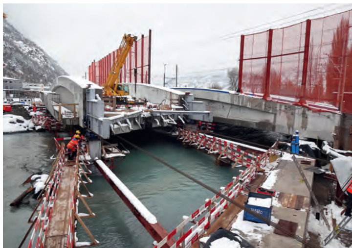
Fig. 7 Überbau während des Längverschubs über die Vispa. Superstructure during the longitudinal shift over the Vispa river.
