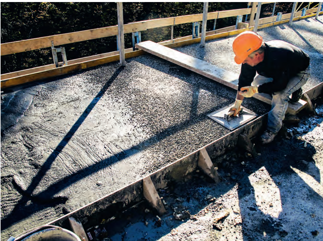
Fig. 6 Mise en place du BFUP et gravillonnage. Installing the UHPFRC and gravelling.
