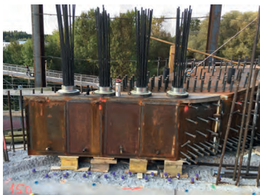
Fig. 6 Rahmenecke Widerlager Dietikon mit vertikaler Loopverankerung. Frame corner of abutment Dietikon with vertical loop tendons.
