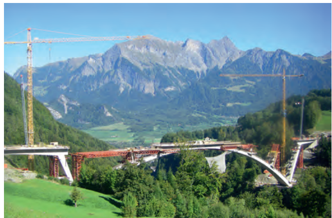
Fig. 8 Herstellung des Überbaus parallel zu Bogenständern. Construction of the superstructure, parallel to arch stands. (© Tiefbauamt Kanton St. Gallen)
