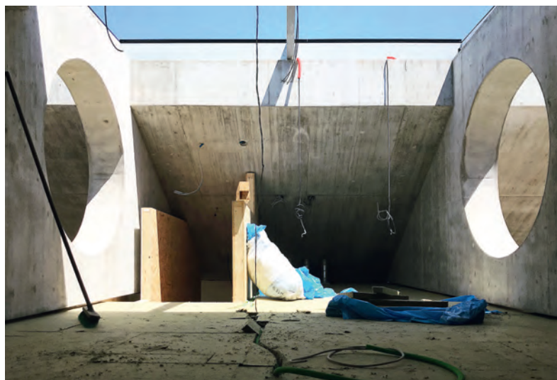
Fig. 7 Zwei Träger bilden jeweils eine Spielnische zwischen zwei Kindergarten- abteilungen und erlauben mit ihren Öffnungen Blickbezüge zwischen diesen. Two beams create a play niche between the kindergarten units, allowing for a visual reference between them through the openings.
