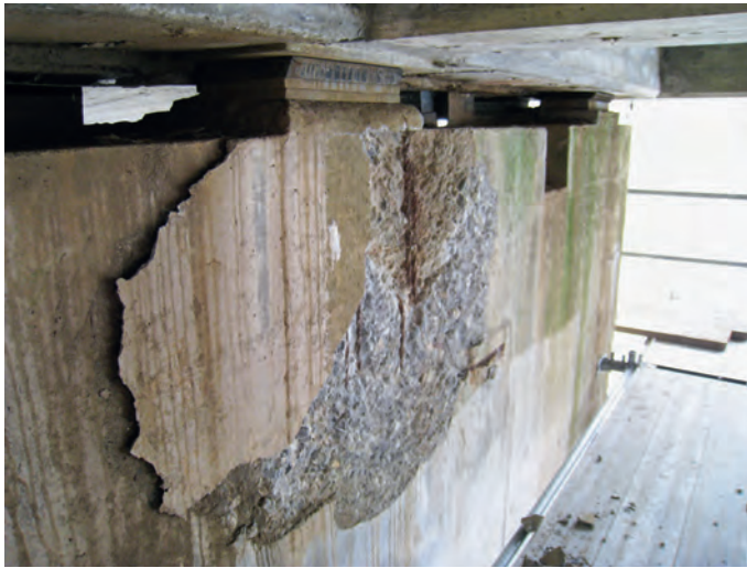
Fig.3 Grossflächige Abplatzung bei Stütze C. Extensive spalling at support C.
