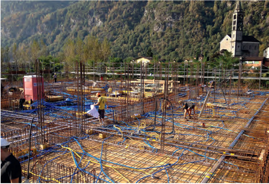
Fig. 9 Vista del cantiere durante la posa dell'armatura del solaio sul secondo piano. View of the construction site during the laying of the slab reinforcement on the second floor. (© Studio Milesi)
