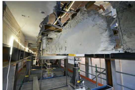
Fig. 10 Vom Gebäude freigeschnittener Stahlbetonunterzug: mit vorgespannten CFK-Schlaufen ertüchtigt und mit 15-cm-Bohrungen ausgestattet. Existing floor beam extracted from the building: strengthened with post-tensioned CFRP loops and perforated with 15 cm bore holes.
