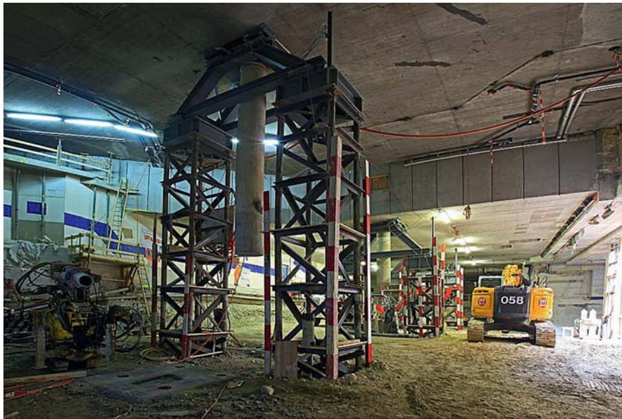
Fig. 3 Für den Bau abgefängene Passage Löwenstrasse. Löwenstrasse Passage underpinned during construction work. (© Marco Püntener)
