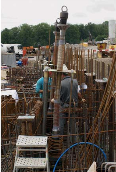
Fig. 5 Bewehrung einer Dachfundation mit Spannkabeln für die Wandscheiben. Reinforcement of a roof foundation with bracing cables for the shear walls.
