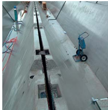
Fig. 7 Nischen und Stahlplattenverbindung in den 3 cm breiten Längsfugen an der Dachoberkante. Block-outs for welding plate connections in the 3 cm-wide gap on the roof ridge.
