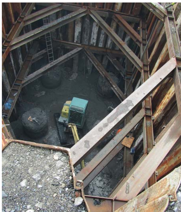
Fig. 4 Terrassement dans enceinte de palplanches pour fondations près des digues du Rhône. Excavations carried out with the help of sheet piles near the dams of the Rhone.
