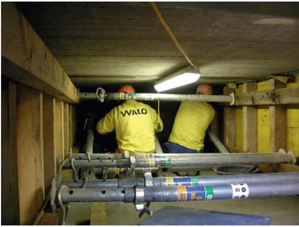
Fig. 7 Verbreiterung der Stegstärken im Hohlkasten. Widening of the webs in the box girder.
