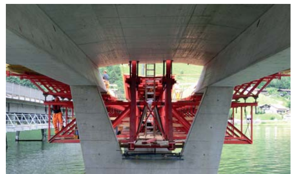
Fig. 7 Vorschubgerüst nach dem Vershub, Montage der Kragarmschalung. Launching-girder after launching, installation of cantilever formwork.
