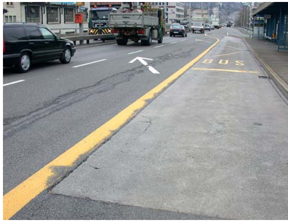
Fig. 2 Der Belag wies Risse und Spurrinnen auf. Road surface shows signs of cracking and rutting.
