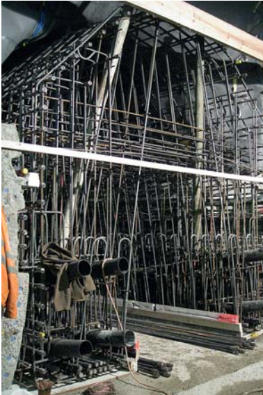
Fig. 4 Bewehrung eines Abfangträgers mit Hüllrohren für die Vorspannung. Reinforcement of a transverse girder with post-tensioning ducts.
